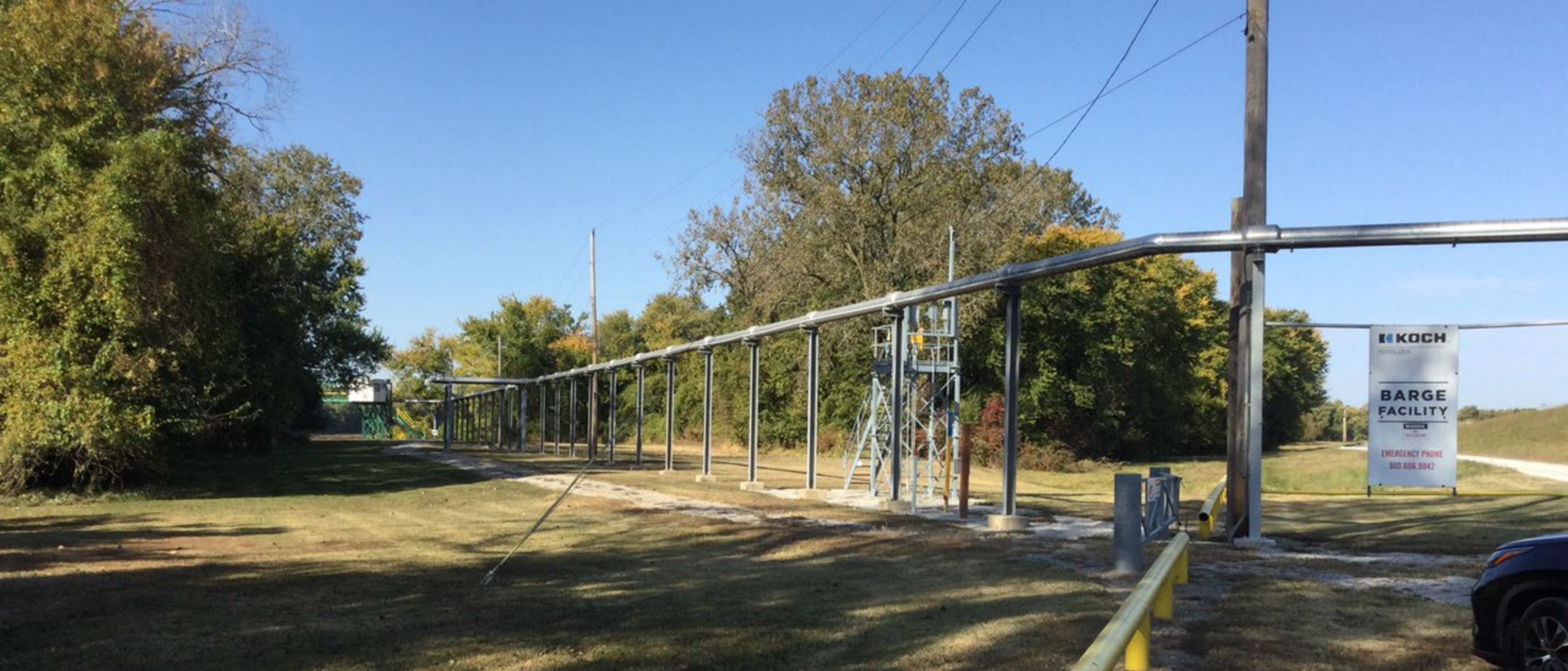
Anhydrous Ammonia Pipeline (land side)
